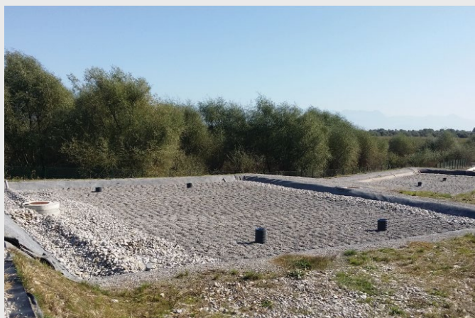
Rastlinska čistilna naprava Vranjina (400 PE). Investicijski stroški: 245.000 €.
