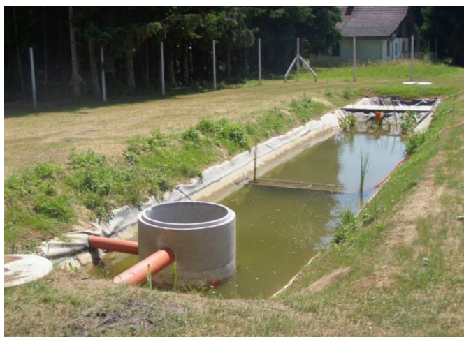
Lagunska čistilna naprava za čiščenje padavinskih voda iz avtoodpada.
